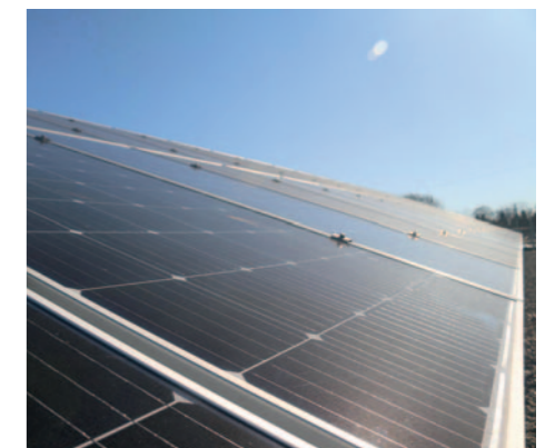
Eigenerzeugter grüner Strom durch Photovoltaik
